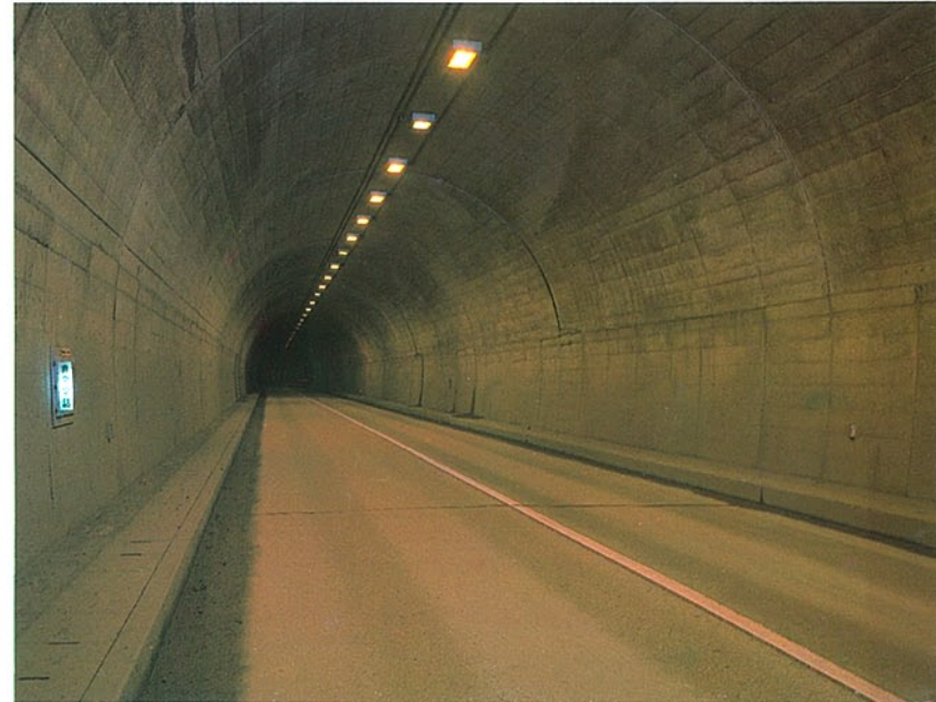
■桑島トンネル照明設備 石川郡白峰村字桑島 ●竣工年度/S.53
