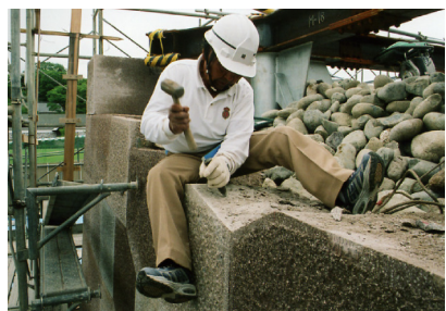
⑦現場合せ状況 ノミにて余分な部分をはつっている
