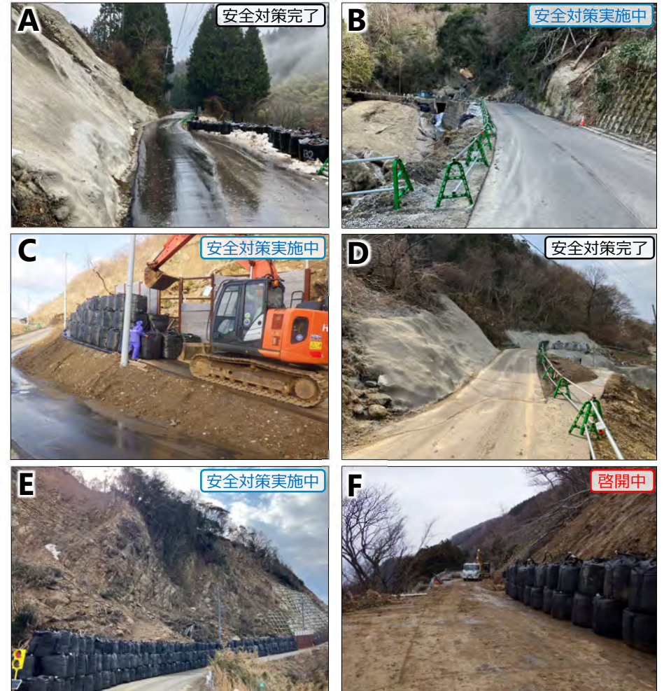
道路啓開の状況 (県道 輪島浦上線)
