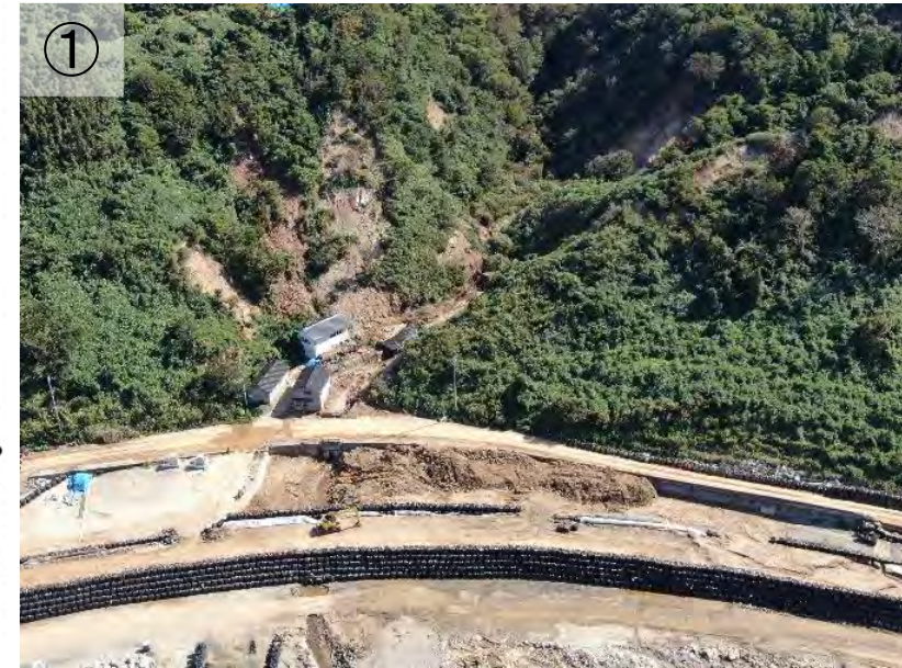
豪雨災害後被災状況
