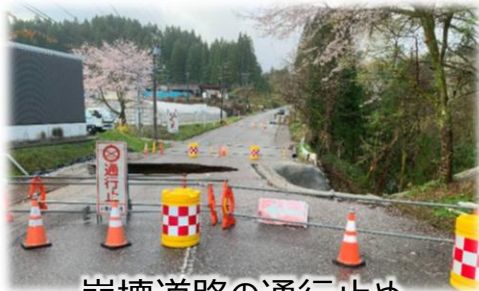
崩壊道路の通行止め
