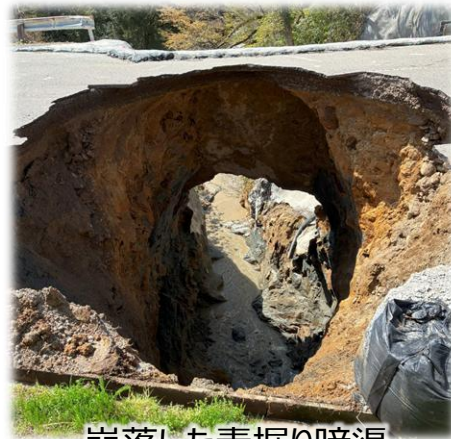
崩落した素掘り暗渠
