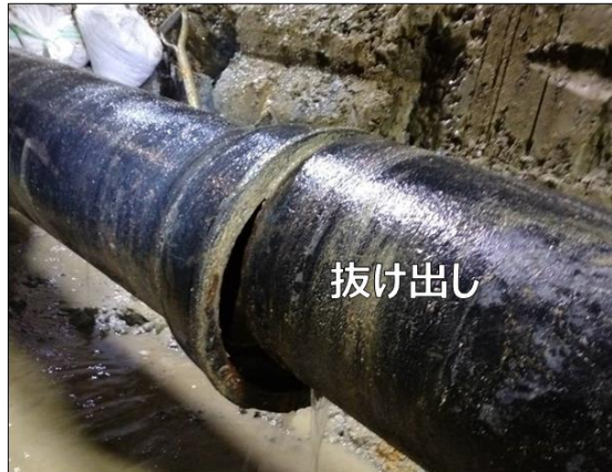
非耐震管の被災状況
