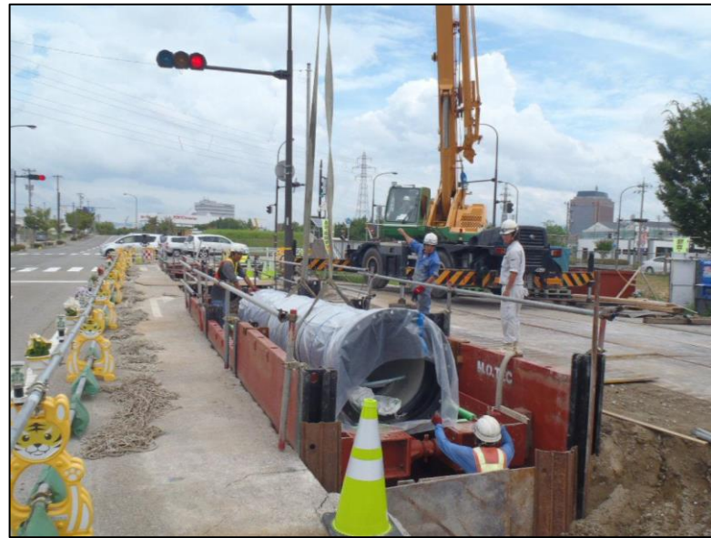
2系統化（耐震管）の整備状況
