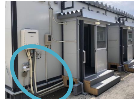
保温材が巻かれた仮設住宅の配管
