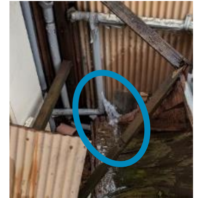
保温材が巻かれていない 露出配管の漏水
