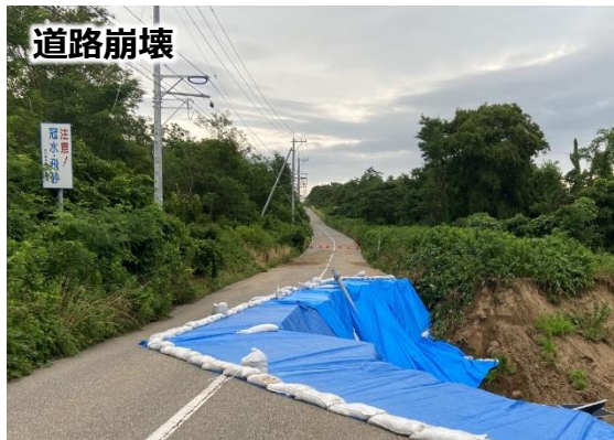
道路崩壊 (一) 高松内灘線 (内灘町西荒屋)
