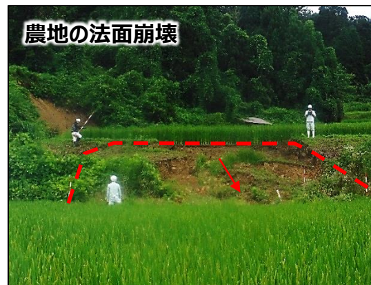
農地の法面崩壊 津幡町八ノ谷
