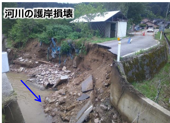
河川の護岸損壊 大海川 (かほく市箕打)
