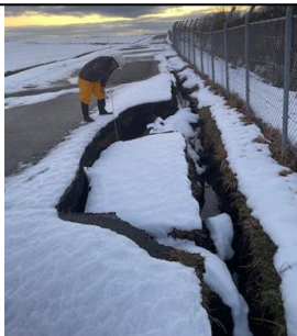
場周道路 (陥没、亀裂)
