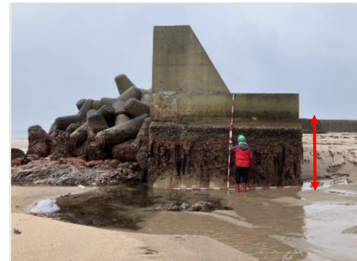
地盤隆起 (鹿磯漁港 (輪島市))
