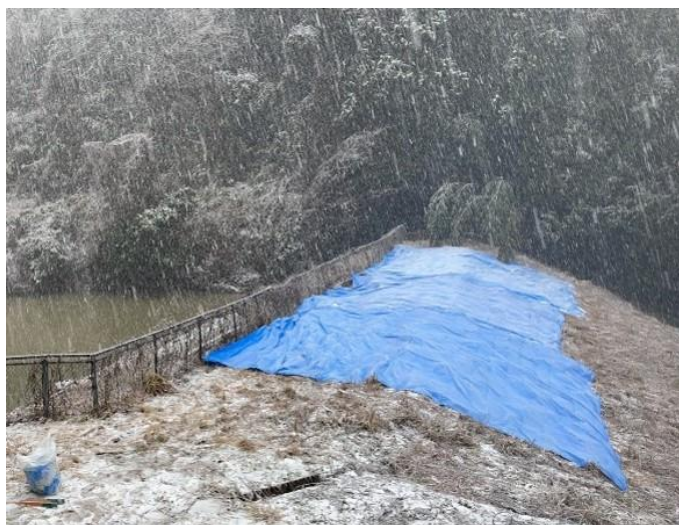
ため池堤防の崩壊 (輪島市小伊勢町)
