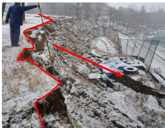
地すべりによる崩落 (輪島市稲舟町)
