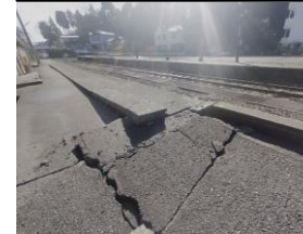
穴水駅ホーム 地盤亀裂・沈下
