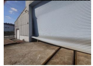
研修庫 シャッター破損
