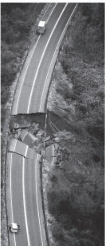
崩壊が大きく陥落した能登有料道。一日に三回行方不明、輪島門前町東地区
