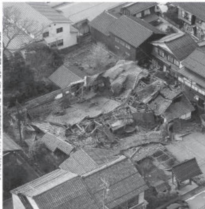
能登半島沖地震で被災した輪島市。市街地はほぼ壊滅し、高齢者ら2500人が避難所生活を強いられている。
