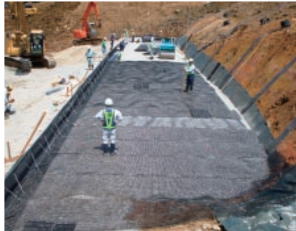
ジオテキスタイルを敷設している状況=7月29日、七尾市中島町土川
