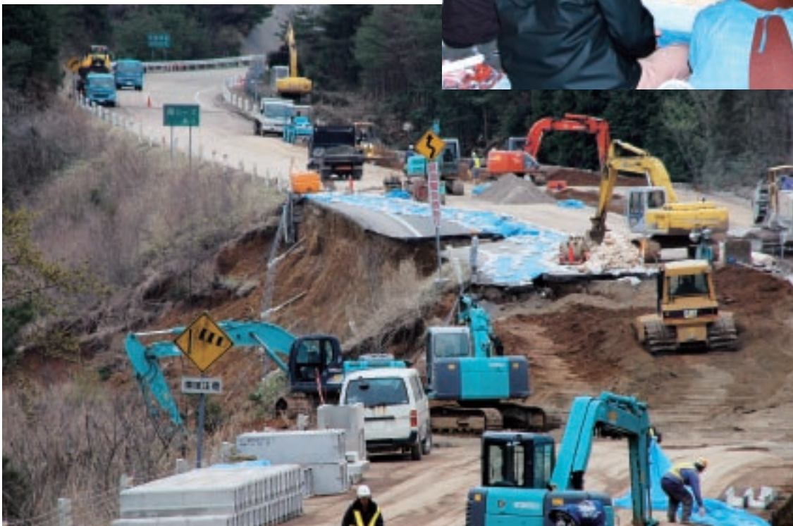
供用再開に向けて応急復旧工事が進められる能登有料道路 = 4月、七尾市中島町小牧
