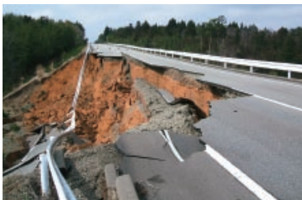
被災状況 広域農道(志賀町給分)
