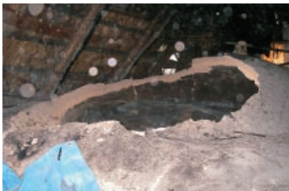
炭窯の天井崩落状況＝3月26日、珠洲市宝立町小屋
