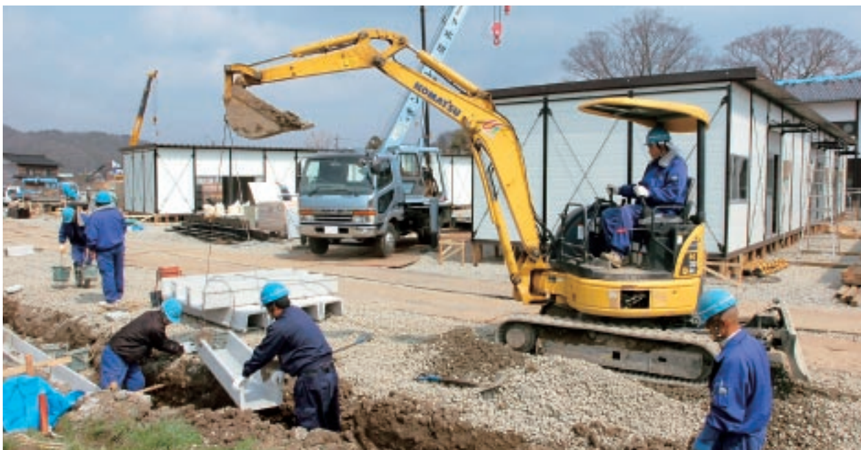
急ピッチで建設作業が進められる応急仮設住宅＝4月、輪島市門前町館
