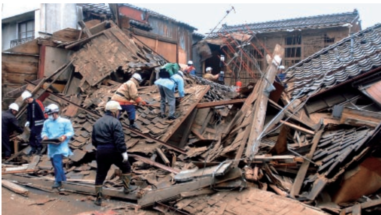
生存者の有無を調べる消防隊員= 3月25日、輪島市河井町
