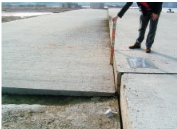
段差が生じた岸壁＝3月27日、輪島港
