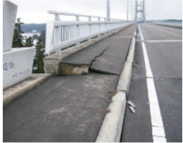
路面亀裂や段差が発生した中能登農道橋
