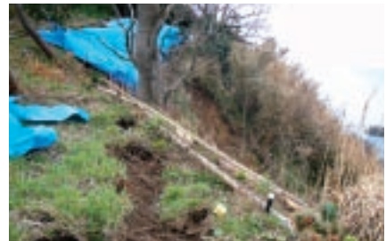
深見地区で発生した斜面の亀裂。地区の全世帯が仮設住宅での生活を余儀なくされた =4月3日
