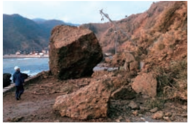
集落に通じる道路に巨石が崩落し、輪島市門前町深見地区（左奥）を孤立させた=3月25日
