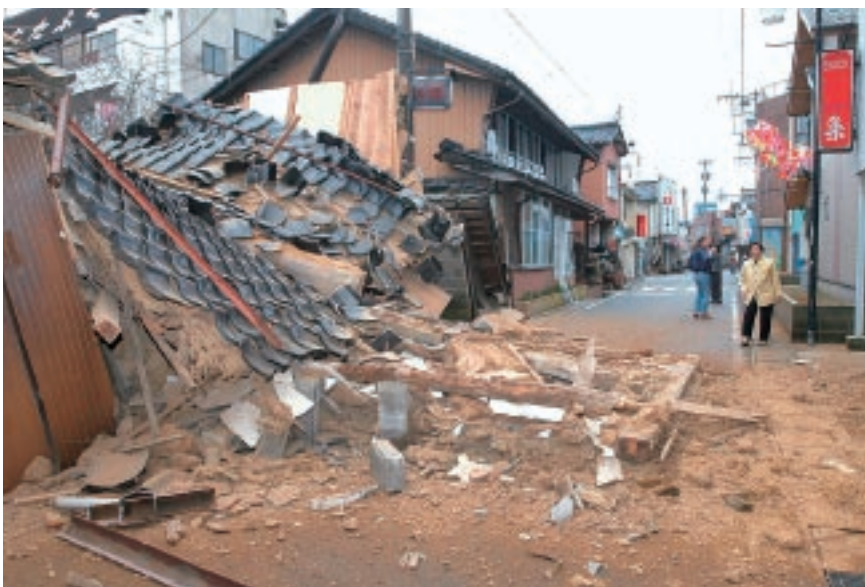
穴水町大町の倒壊家屋。 穴水町は輪島市に次いで全壊棟数が 多かった＝3月25日
