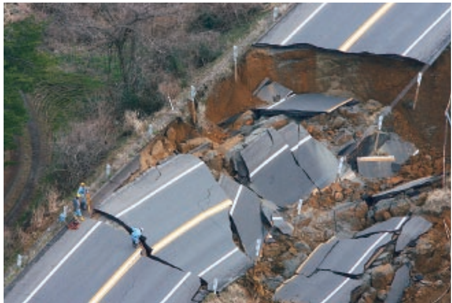
能登有料道路は至るところで崩落し、能登 の生命線は寸断された＝3月25日、七尾 市中島町谷内
