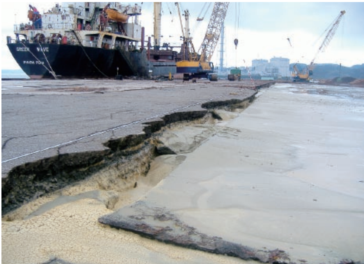
地盤の液状化により、岩盤とふ頭用地の間に段差が発生した七尾港大田地区（国土交通省北陸地方整備局提供）
