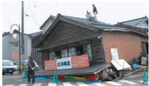
のと鉄道穴水駅近くの商店は、3月25日の本震で前面に大きく傾き、繰り返す余震で後日、1階部分がつぶれた＝穴水町大町
