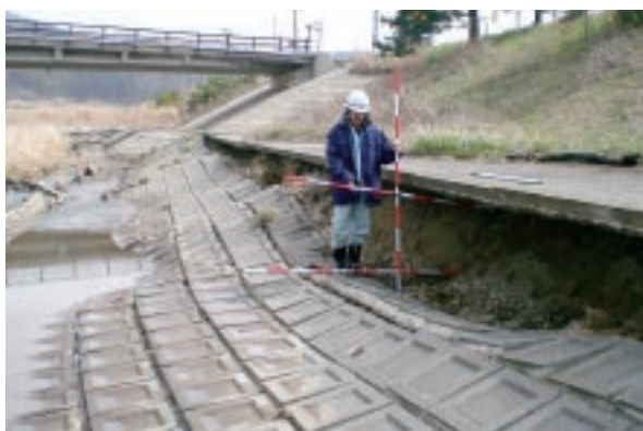
護岸が崩れた輪島市門前町の二級河川八ヶ川(はっかがわ)＝3月26日
