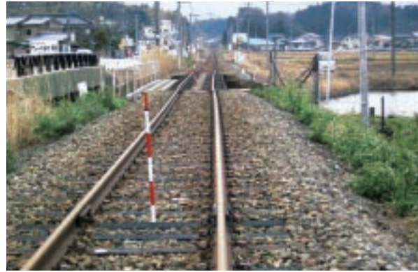
前後300mにわたり赤浦湯側に線路が移動した七尾・和倉温泉間松百川橋りょう=平成19年3月
