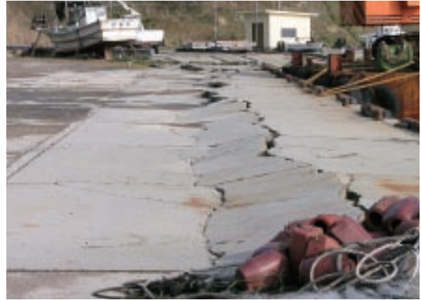
物揚場が隆起、亀裂が入った＝3月、鹿磯漁港
