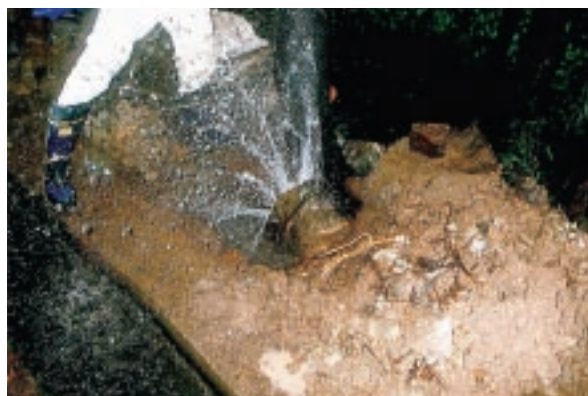
穴水町上水道宇留地浄水場系導水管の破損
