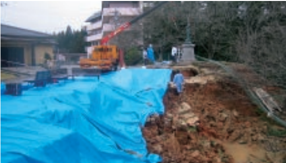
敷地の土砂が崩落した老人福祉施設
