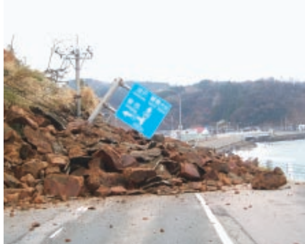
土石でふさがれた輪島市里町の国道249号=3月25日
