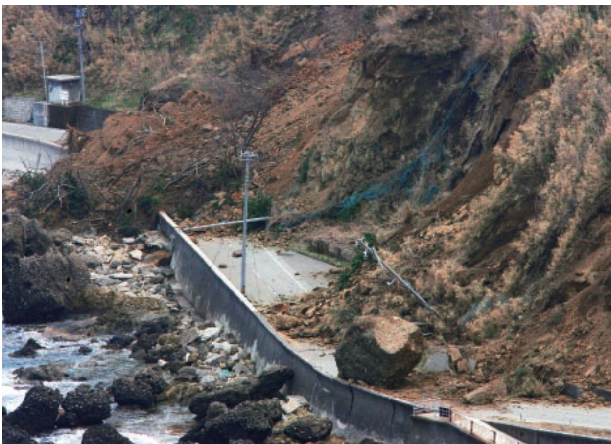
集落に通じる道路に巨石が崩落し、孤立した輪島市門前町深見地区＝3月26日
