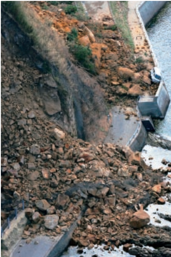
観光名所「鴨ヶ浦」の海岸の崖が崩れ、海岸道路は通行不能になった =3月26日、輪島市輪島崎町
