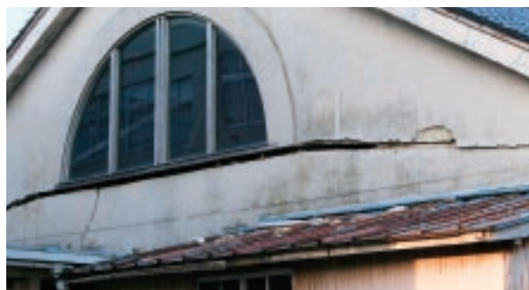
半壊した穴水小学校体育館の屋根部分 = 3月25日
