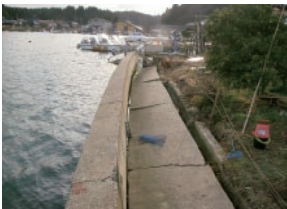
傾斜が生じた海岸護岸＝3月27日、穴水港
