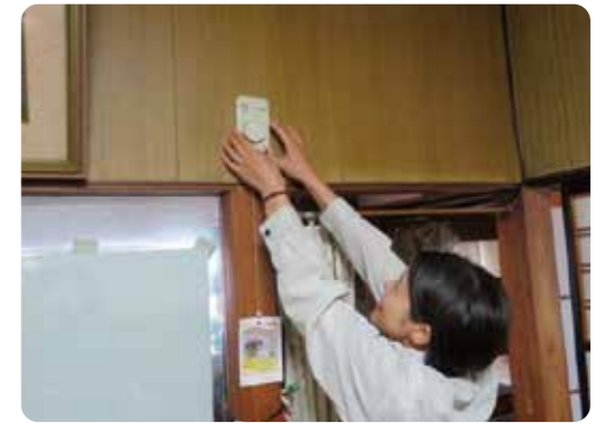
火災警報器の点検
